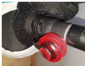
Photo 15: Flexible avec raccord attaché à la vanne.
