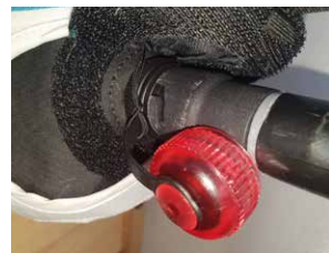
Photo 16: Flexible avec raccord attaché à la vanne.
